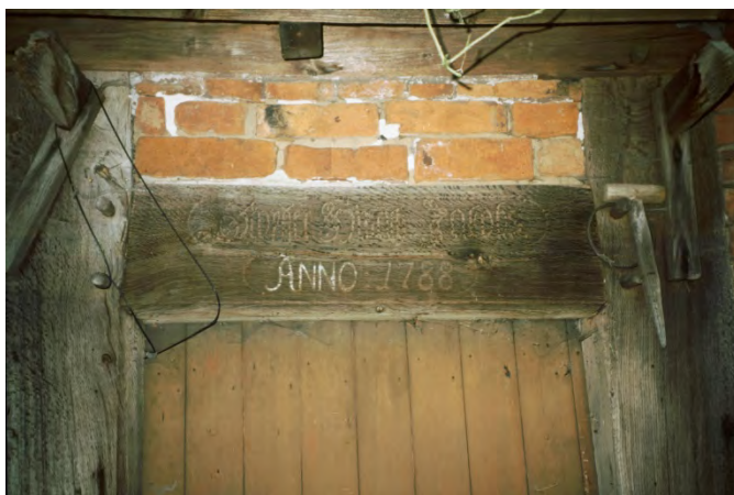
Abb. 2: Das eingeschnittene Datum „ANNO 1788“ über der linken Seitentür deutet auf eine jüngere Bauphase hin.
